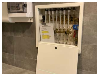
Rør-i- rørs skap, bolig
