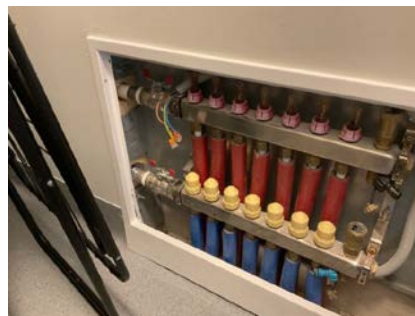
Vannbåren varme i leilighet
