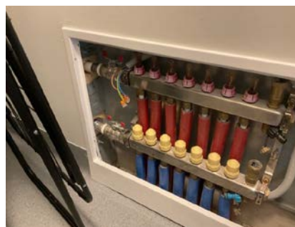
Vannbåren varme i leilighet
