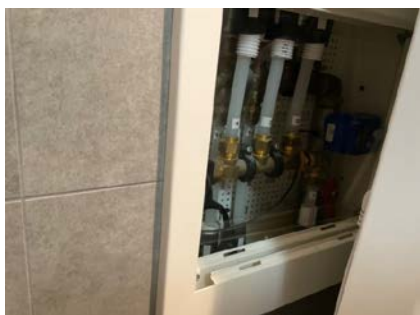
Rør-i rør skap, leilighet
