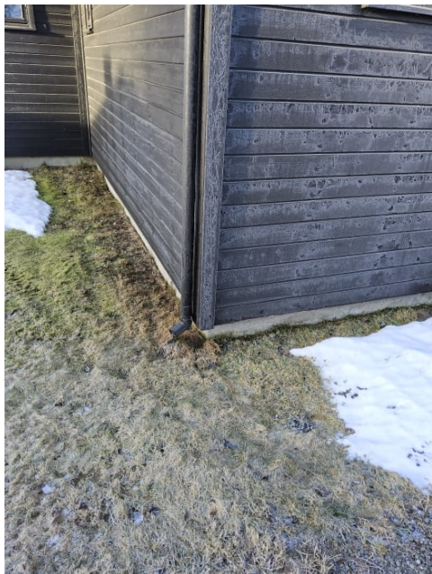
Bilde viser taknedløp avsluttet over bakken.
