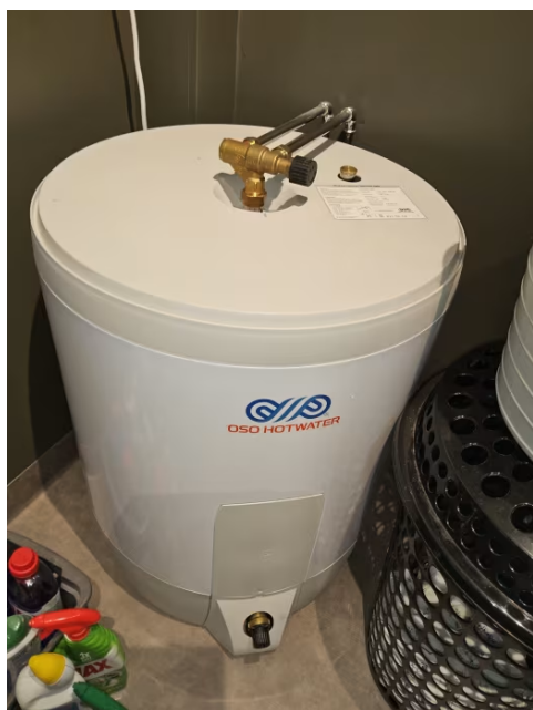
Bilde viser varmtvannsbereder.
