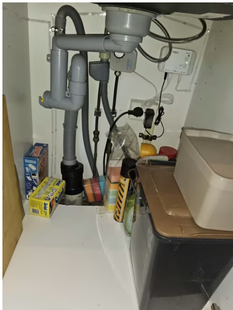
Bilde viser røropplegg under oppvaskkum.
