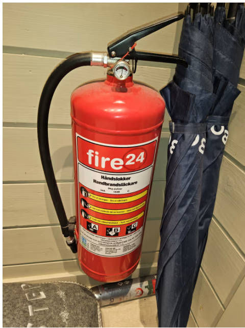
Bilde viser brannslukningsapparat.
