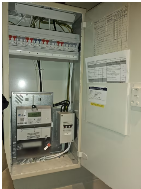
Bilde viser sikringskap.
