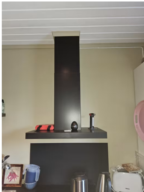
Bilde viser mekanisk avtrekk på kjøkken.
