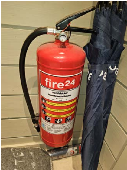
Bilde viser brannslukningsapparat.
