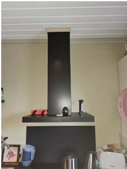
Bilde viser mekanisk avtrekk på kjøkken.
