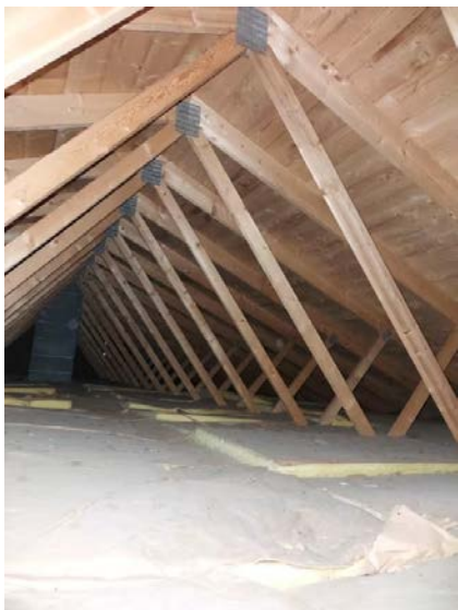
Bilde viser kaldtloft.
