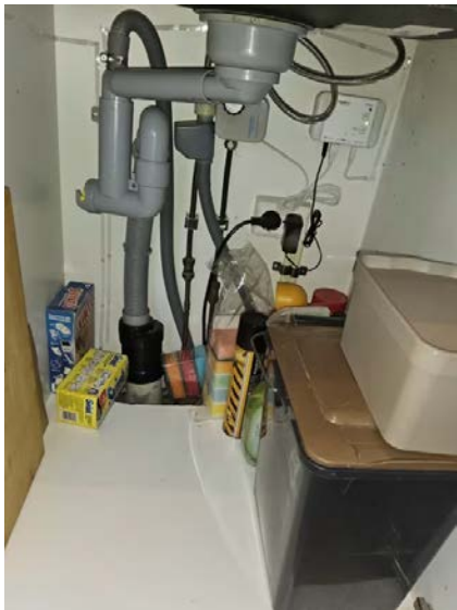
Bilde viser røropplegg under oppvaskkum.
