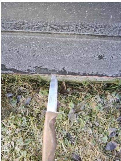
Bilde viser råteskade i nedre del av kledning.
