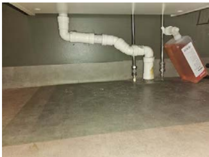
Bilde viser avløpsrør på bad.
