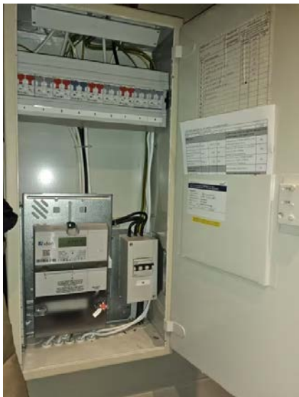
Bilde viser sikringskap.
