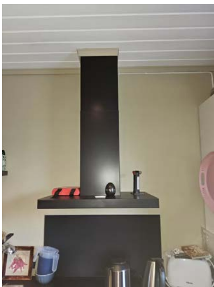
Bilde viser kjøkkenventilator.
