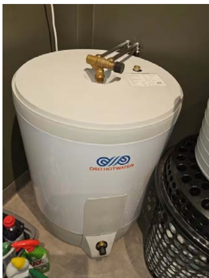
Bilde viser varmtvannsbereder.
