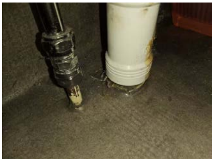
Bilde viser rørgjennomføring i gulv.
