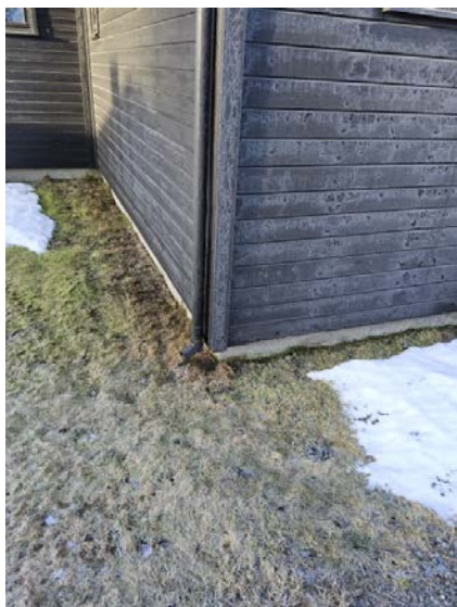
Bilde viser taknedløp avsluttet over bakken.
