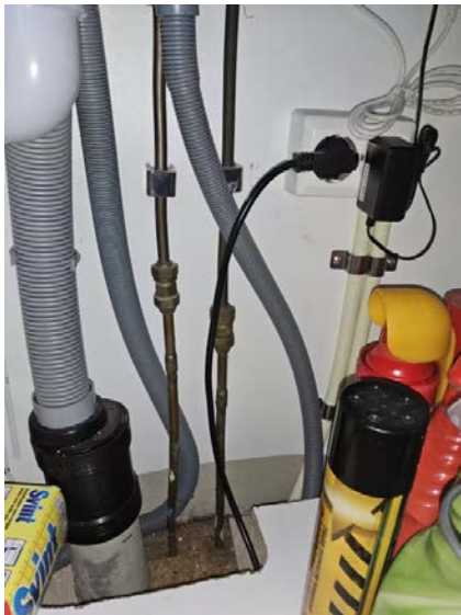
Bilde viser vannrør på kjøkken.
