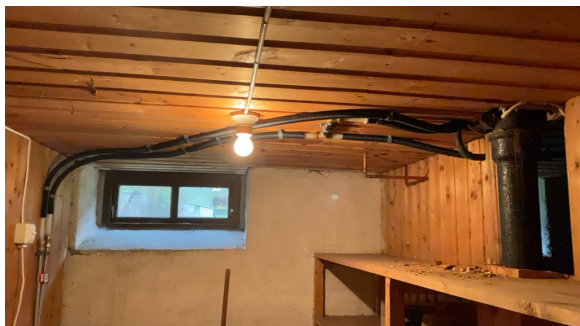
Rørøppløp kommer ut i bod hvor det ikke er sluk.
