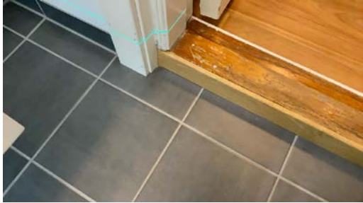
Ikke mulig å sjekke eventuell oppkant på membran ved dørterskel.
