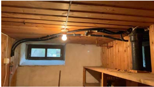
Røropplegg kommer ut i bod hvor det ikke er sluk.
