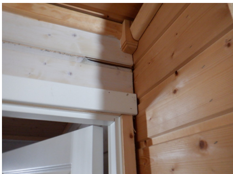
Listverk bør utbedres.
