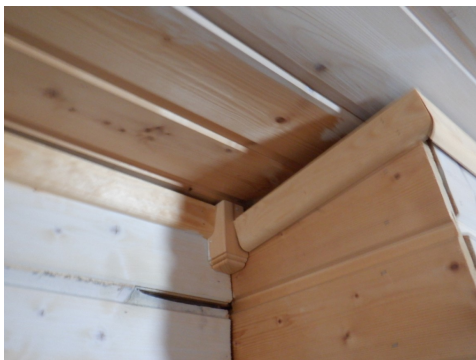
Listverk bør utbedres.
