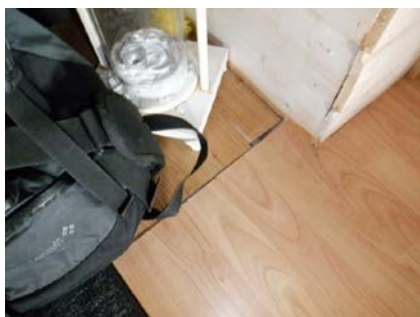
Listverk bør utbedres.
