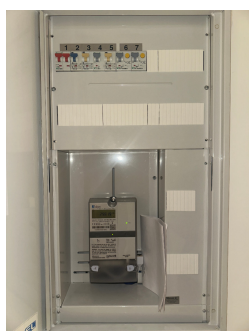
Sikringsskap med automatsikringer.
