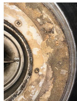
Manglende membran rundt sluk
