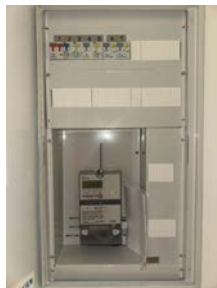
Sikringsskap med automatsikringer.
