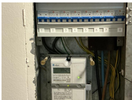
Jordfeilbrytere i sikringskap plassert i gang/fellesareal.
