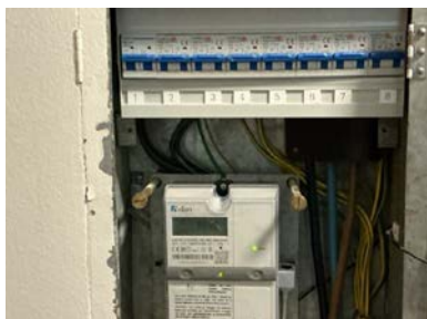
Jordfeilbrytere i sikringskap plassert i gang/fellesareal.
