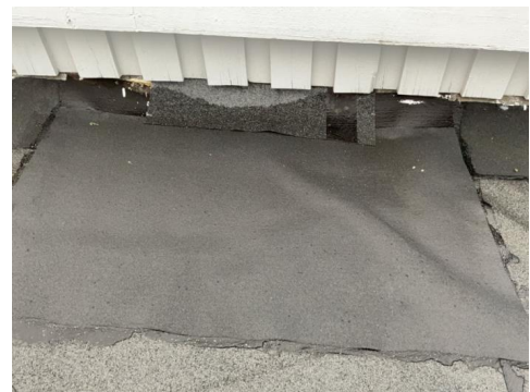
Ufagmessig utførelse på takteking.
