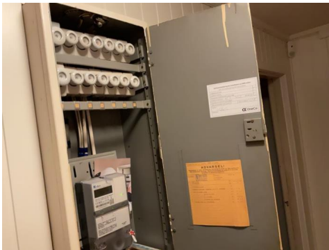
Sikringskap med kursfortegnelse i samsvar med antall sikringer.
