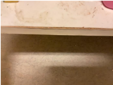
Svellskader på baderomsinnredning.
