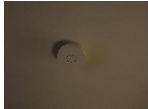
Røykvarsler montert i stue.
