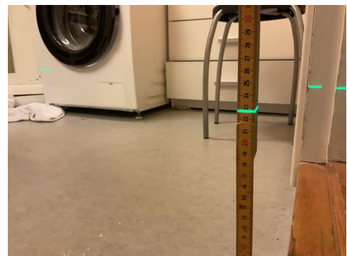
Det er målt 22,8 cm på gulv ved terskel.
