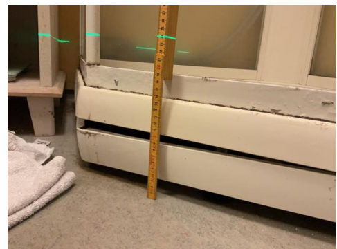
Det er målt 24cm ved dusjkabinett.
