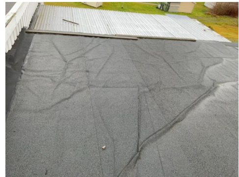
Ufagmessig utførelse på takteking.
