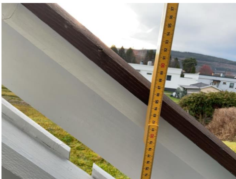
Rekkverk er målt til 87cm fra starten på inntrinn.
