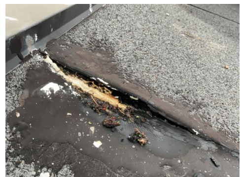
Pappskjøt løsner i skjøt.
