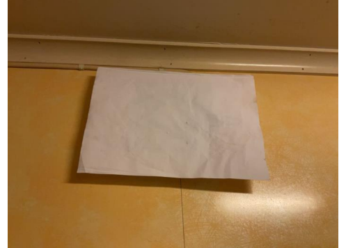
Ark henger på ventil. Bra avtrekk.
