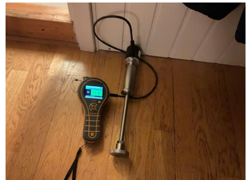
Fuktsøk i svill med hammerelektrode uten unormale resultater.
