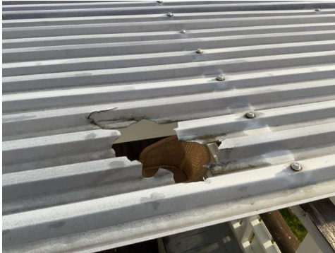
Skade i takplate.
