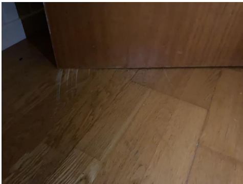
Eksempel på at dør tar i gulv ved åpning/ lukking.
