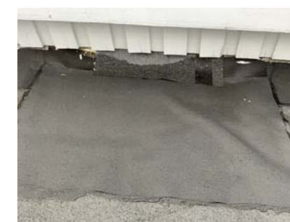
Ufagmessig utførelse på takteking.
