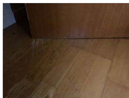
Eksempel på at dør tar i gulv ved åpning/ lukking.
