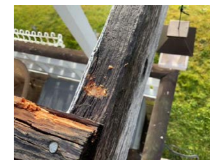
Råte i ytterste bærebjelke.
