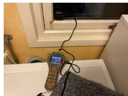
Det er målt fukt enkelte plasser på vindu i våtrom.
