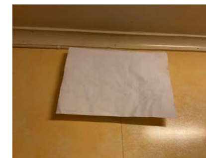
Ark henger på ventil. Bra avtrekk.
