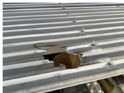
Skade i takplate.
