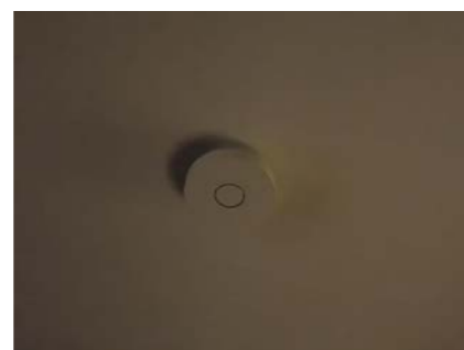
Røykvarsler montert i stue.
