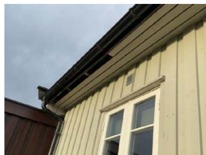
Eksempel på at bordkledning mangler i takutstikk.
