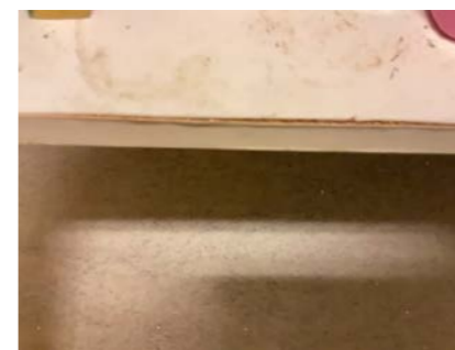
Svellskader på baderomsinnredning.
