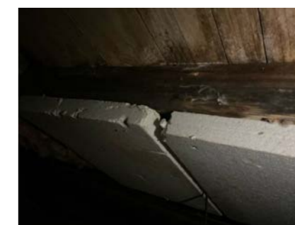
Antydninger til fukt og råteskadet treverk under stubbeloft.
