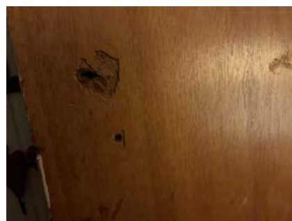
Skade i dørblad.
