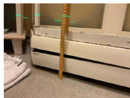
Det er målt 24cm ved dusjkabinett.
