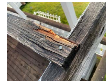
Eksempel på råte.
