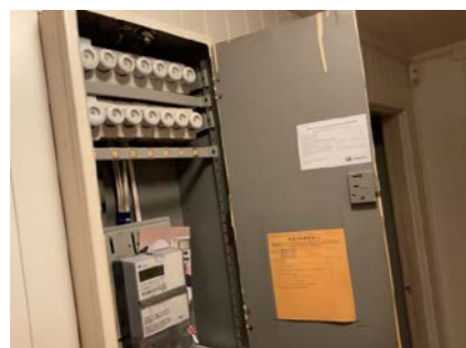
Sikringsskap med kursfortegnelse i samsvar med antall sikringer.
