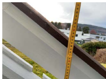
Rekkverk er målt til 87cm fra starten på inntrekk.
