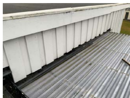
ufagmessig utførelse på beslag over terrasse.
