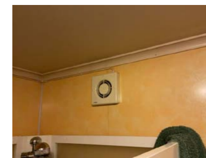
Elektrisk styrt vifte.
