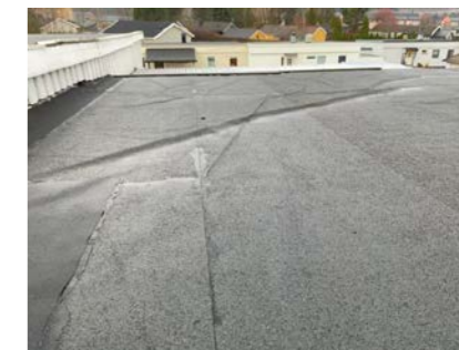
Ufagmessig utførelse av takpapp.
