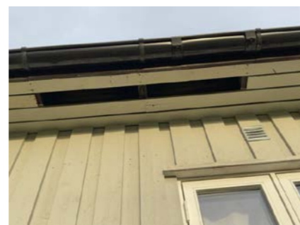
Eksempel på at bordkledning mangler i takutstikk.
