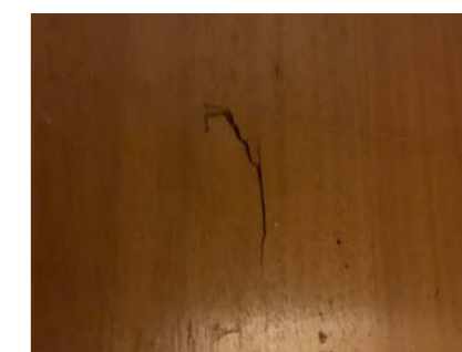
Skade i dørblad.
