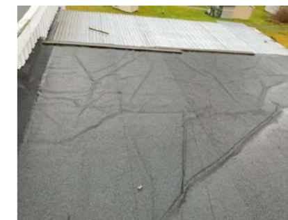
Ufagmessig utførelse på takteking.
