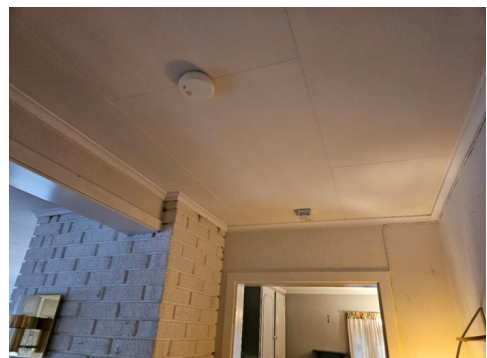
Røykvarsler ved kjøkkenet.
