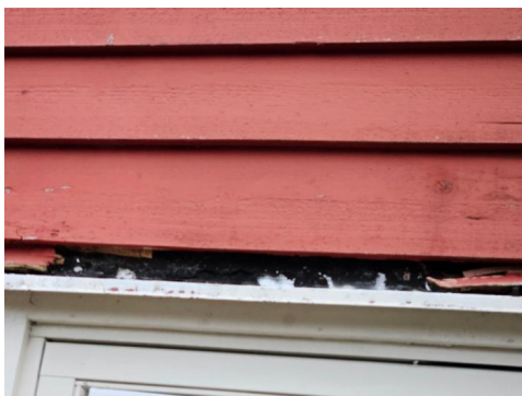
Råte i overkant av kjøkkenvindu.
