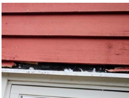
Råte i overkant av kjøkkenvindu.
