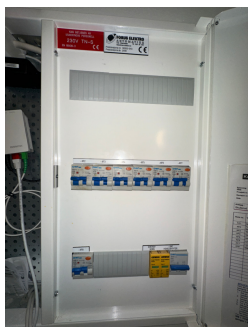
Sikringsskap med automatsikringer.
