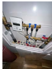
Samleskap med rørkurser og stoppekraner
