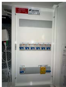
Sikringsskap med automatsikringer.
