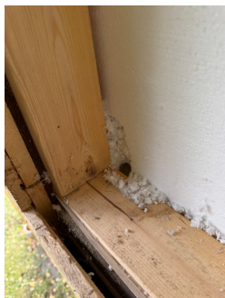
Spor fra skadedyr ved loftsluke (inngang til loft)
