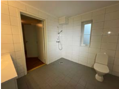
Vindu og dør er plassert i en våtsone
