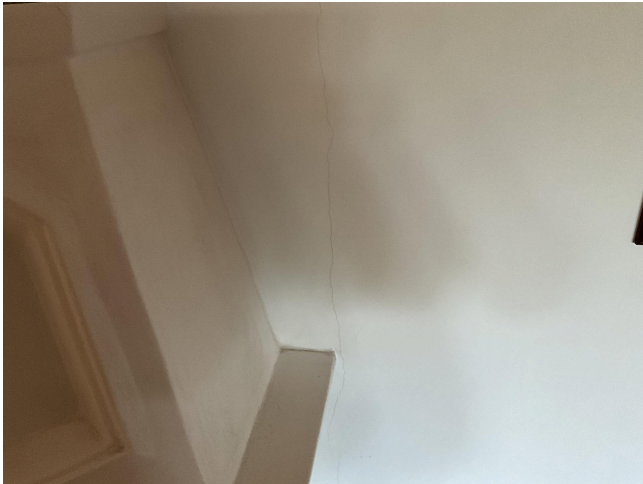
Bilde av sprekke ved skorsteinen.
