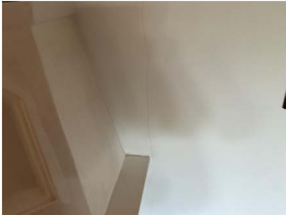
Bilde av sprekk ved skorsteinen.
