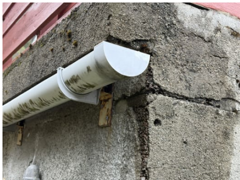
Synlige sprekker som krever tiltak.
