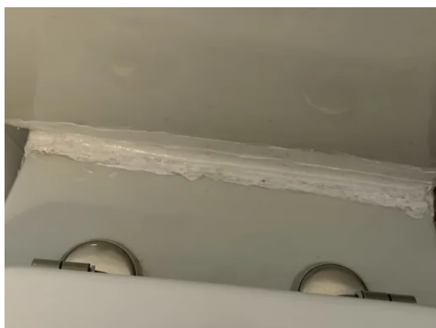
Silikonfuge på wc.
