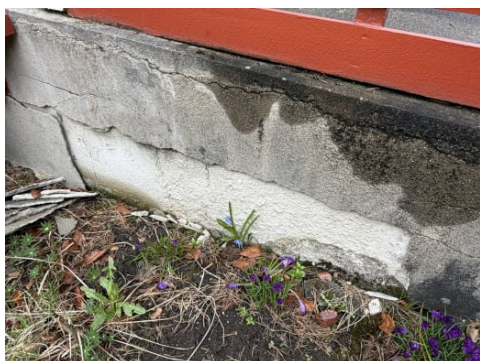
Løs murpuss mot garasje.
