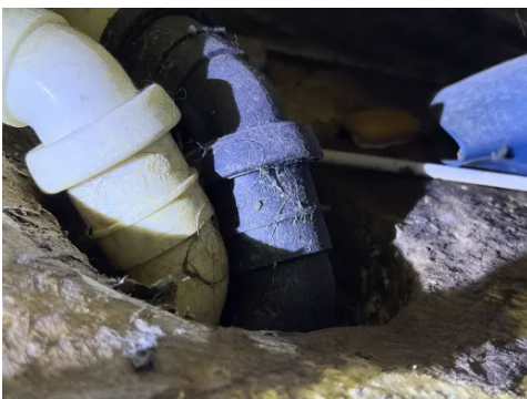
Begrenset kontroll av sluk.
