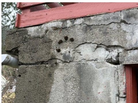
Synlige sprekker som krever tiltak.
