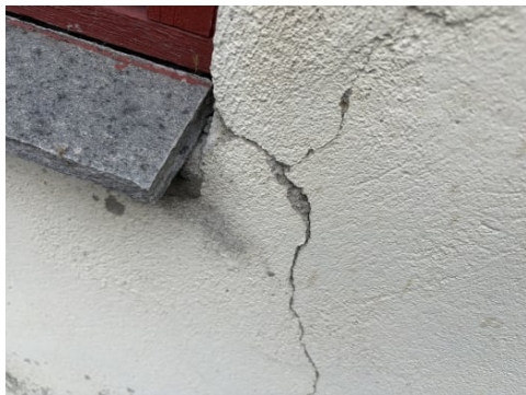
Stedvis sprekker/ riss på grunnmur.
