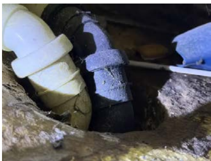
Begrenset kontroll av sluk.
