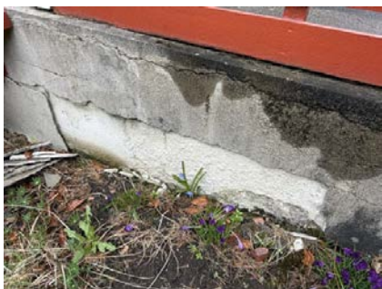
Løs murpuss mot garasje.
