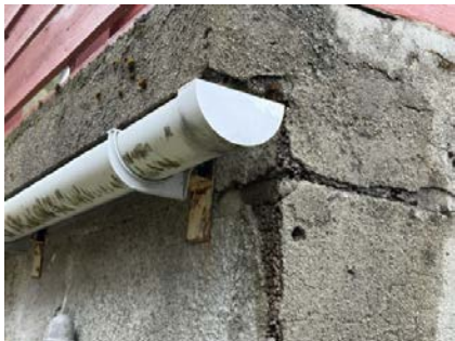
Synlige sprekker som krever tiltak.
