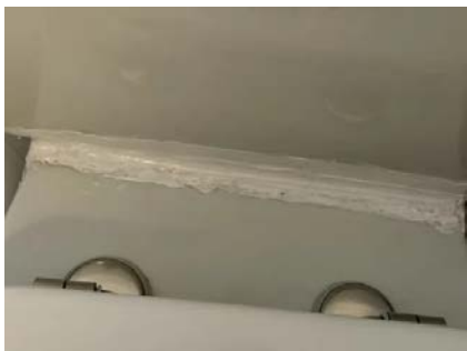
Silikonfuge på wc.
