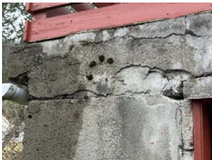
Synlige sprekker som krever tiltak.
