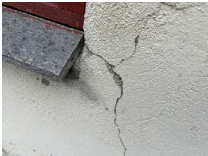
Stedvis sprekker/ riss på grunnmur.
