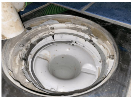
Plastsluk og synlig slukmansjett ført under slukets klemring.
