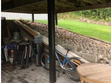
Forstøtningsmur under terrassen uten rekkverk.
