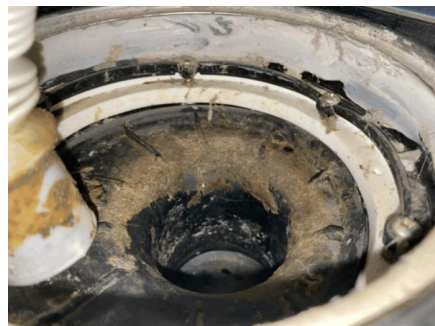
Plastsluk og synlig smøremembran rundt sluk.
