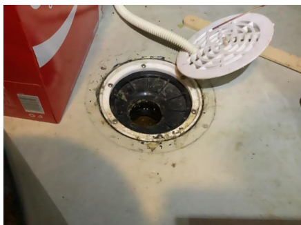
Plastsluk i malt betonggulv.
