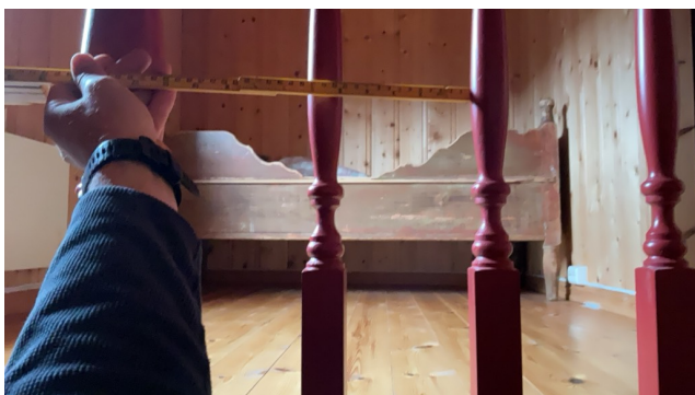
Åpning i rekkverk fra 2.etg er over krav
