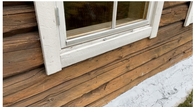
Det mangler vannbrett under og over vindu
