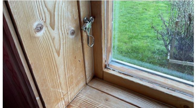
Slitasje i karm, trolig medvirkende er kondens og vedlikeholdsetterslep
