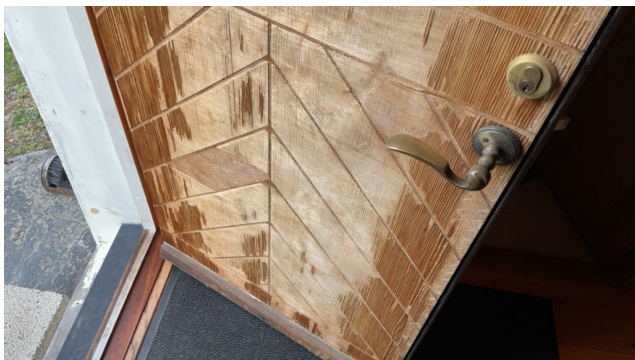
Slitasje på ytterdør
