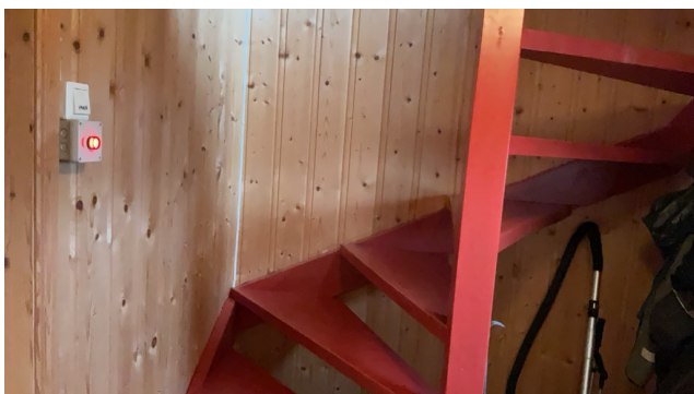
Mangler rekkverk/håndløper i trapp
