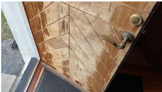
Slitasje på ytterdør
