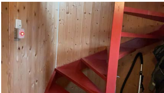
Mangler rekkverk/håndløper i trapp
