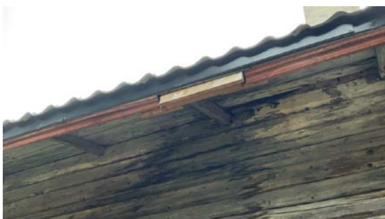
Enkel/ufagmessig utførelse av forkantbord som er skjøtet på overside
