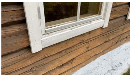
Det mangler vannbrett under og over vindu
