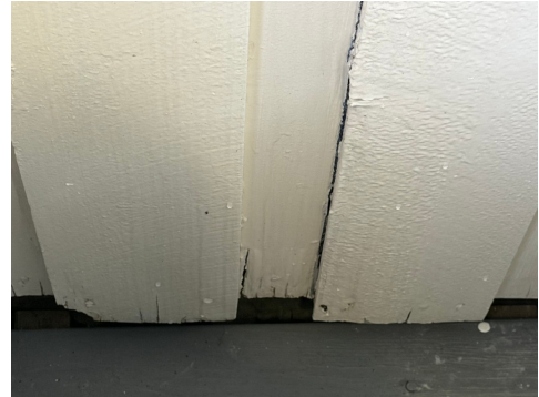
Råte i nedre del av kledningsbord v/ altan.
