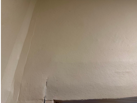
Ujevn veggoverflate i gang.
