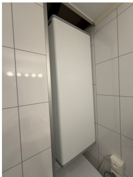
Vegghengt varmtvannstank på bad.
