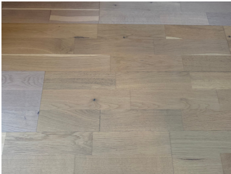
Fargeforskjell i parkett i stue. Skyldes sannsynligvis at tidligere eier har lagt to forskjellige parkett typer.
