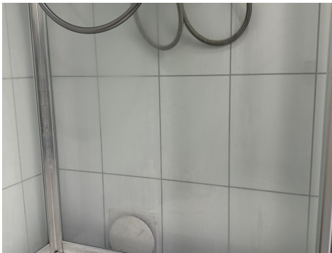
Ventil i nedre del av vegg i dusjsone (Ukurant løsning).
