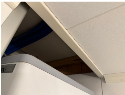
Synlige rør og panel i øvre del av vegg v/ varmtvannstank.
