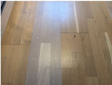
Fargeforskjell i parkett på kjøkken. Skyldes sannsynligvis at tidligere eier har lagt to forskjellige parkett typer.
