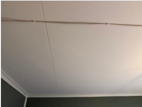
Takplater på soverom har kortskjøter på samme sted. Normalt sett skal kortskjøter på takplater ligge med 60 cm avstand fra hverandre.
