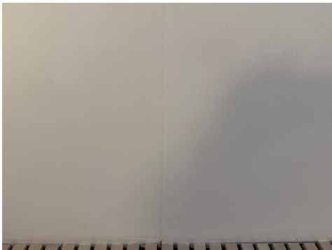
Riss i plateskjøt i stuehimling.
