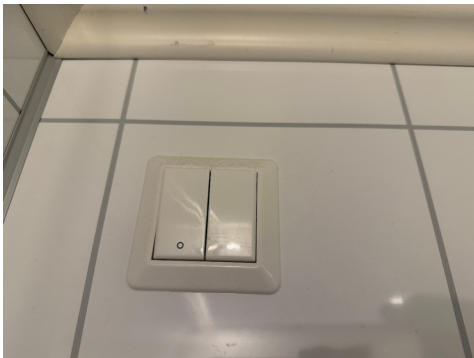
Bryter til el.avtrekksventil. Må være påslått v/ dusjing.
