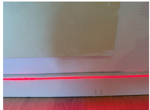
Bilder viser skjevheter i gulv på kjøkken.
