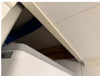
Synlige rør og panel i øvre del av vegg v/ varmtvannstank.
