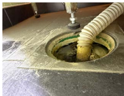
Plastsluk i dusjsone.
