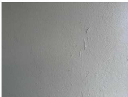
Malingslitt på skillevegg.
