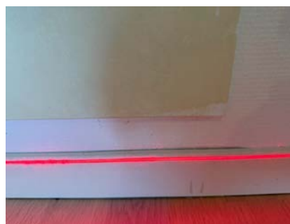
Bilder viser skjevheter i gulv på kjøkken.
