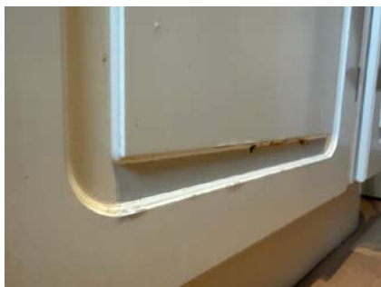
Slitasje/svelling i nedre del av skapfront under vask.
