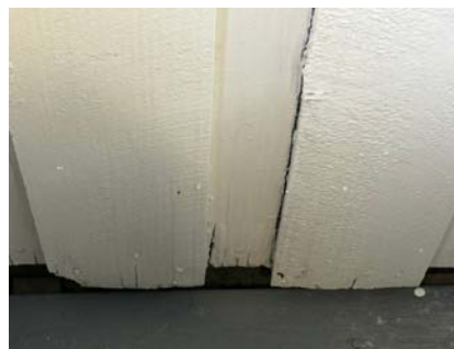
Råte i nedre del av kledningsbord v/ altan.
