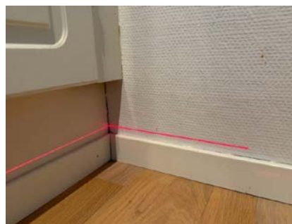
Bilder viser skjevheter i gulv på kjøkken.
