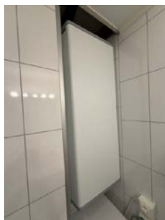
Vegghengt varmtvannstank på bad.
