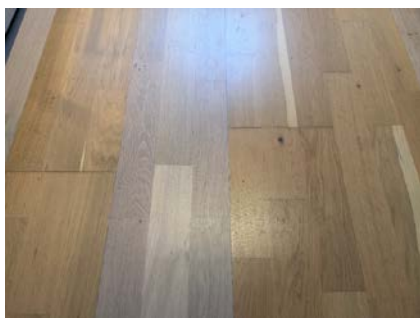
Fargeforskjell i parkett på kjøkken. Skyldes sannsynligvis at tidligere eier har lagt to forskjellige parkett typer.
