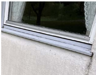
Vindu med utvendig slitasje på treverk.
