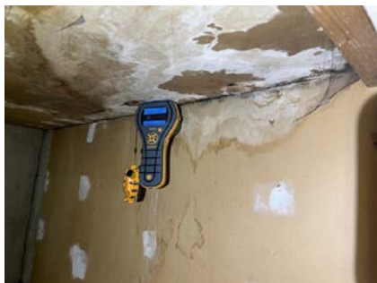
Fukt og råteskade i bod ved pipe. Fuktmåling viste ikke utslag på fukt.
