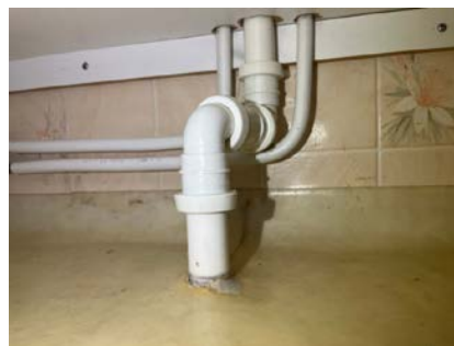
Gjennomføringer i gulv er ikke tette.
