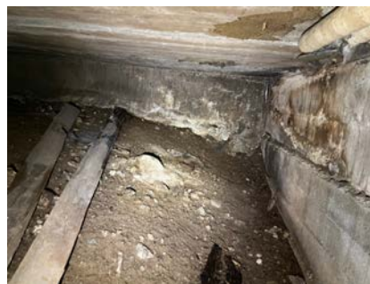
Krypkjeller med synlig fuktinntrenging.
