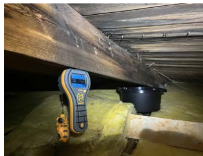
Råteskadet taksperre og undertak. Fuktmålinger viste ikke utslag på fukt.
