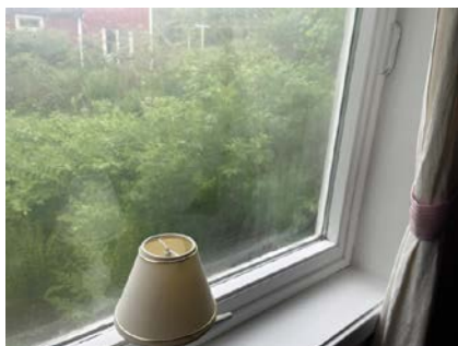
Vindu med punktert glass i 1.etasje.
