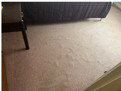
Vegg-til-vegg tepper er nedslitte.
