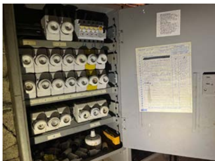
El-skap i kjellerbod.
