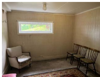
Kjellerstue har fuktskader på veggoverflater.
