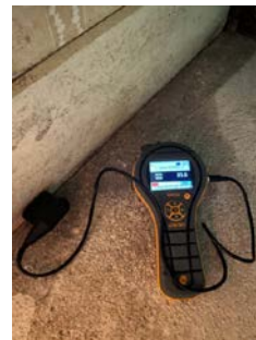
Fuktmålinger viste skadelig fukt.
