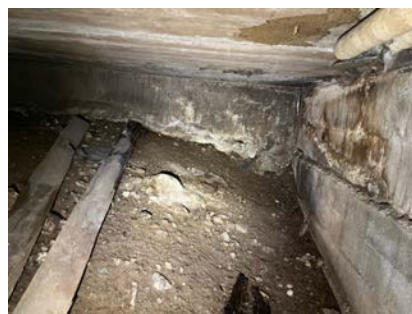
Fukttinnis fra terreng til underetasje.
