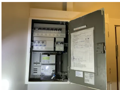
Sikringsskap står i felles gang.
