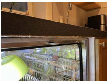
Noe svelling på benkeplate over oppvaskmaskin.
