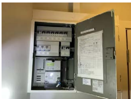
Sikringsskap står i felles gang.
