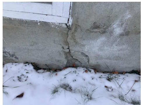
Eksempel på sprekke i grunnmur.
