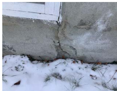
Eksempel på sprekke i grunnmur.
