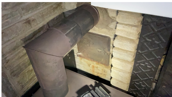
Sotluke plassert på stue.
