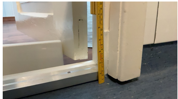
Oppbrett ved terskel målt til 25mm.
