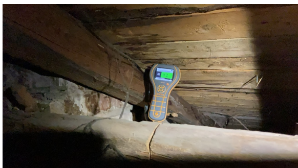
Synlig fuktmerker på undertak.
