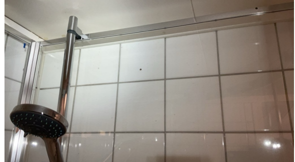
Veggene har gjenværende hull etter tidligere installasjon.
