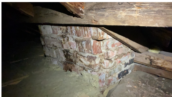
Rennemerker på pipe på loft.
