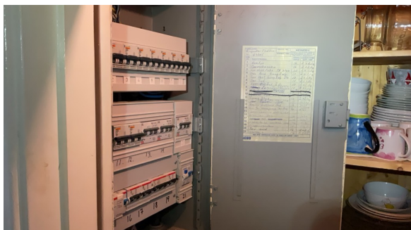
Sikringsskap plassert på bod loftsetasje.
