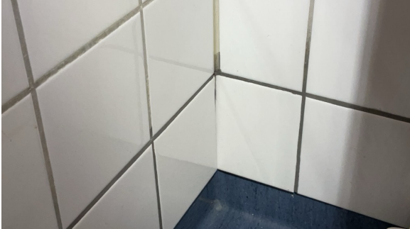
Riss eller sprekker i fuger registrert.
