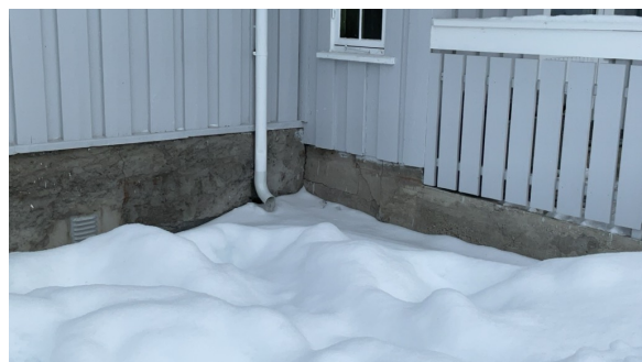
Sprekker i grunnmur flere steder.
