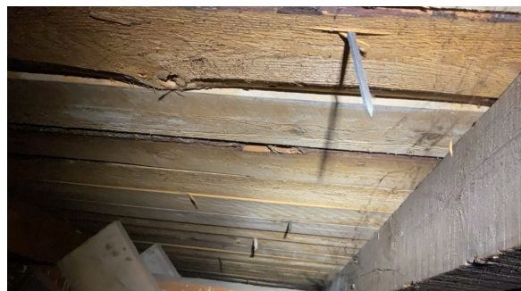
Spiker stikker gjennom undertaket flere steder.
