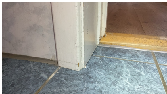
Ingen synlig oppbrett av membran ved terskel.
