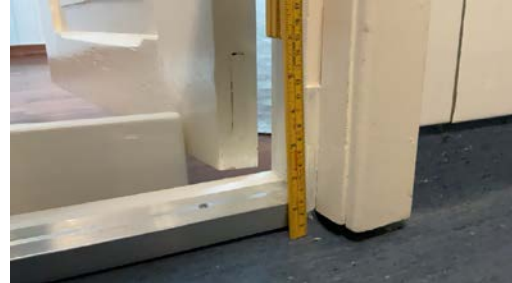
Oppbrett ved terskel målt til 25mm.
