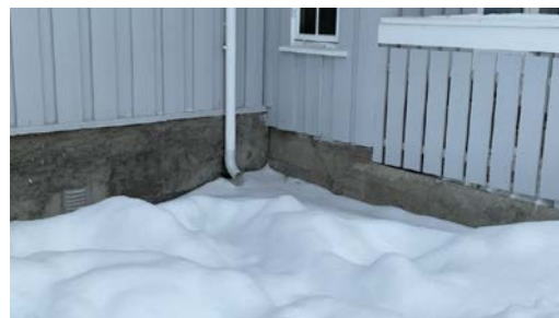
Sprekker i grunnmur flere steder.
