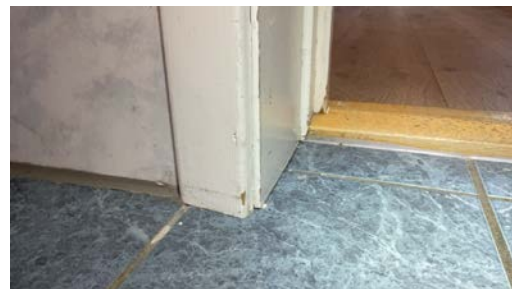
Ingen synlig oppbrett av membran ved terskel.
