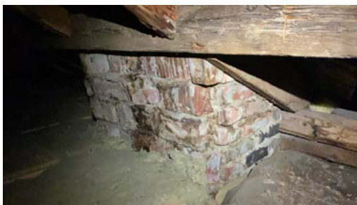
Rennemerker på pipe på loft.
