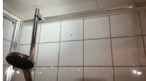
Veggene har gjenværende hull etter tidligere installasjon.
