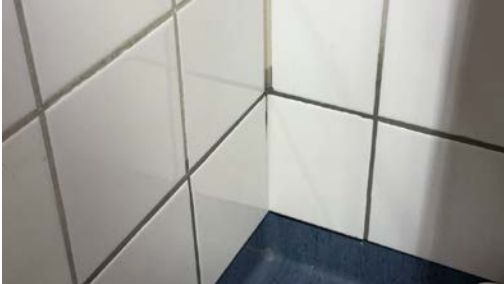
Riss eller sprekker i fuger registrert.
