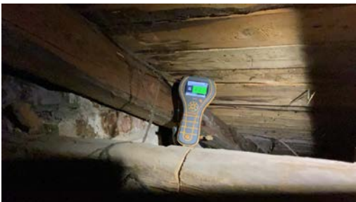
Synlig fuktmerker på undertak.
