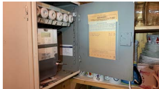
Sikringsskap plassert på bod loftsetasje.
