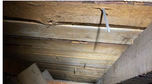
Spiker stikker gjennom undertaket flere steder.
