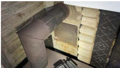
Sotluke plassert på stue.
