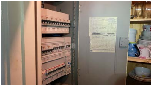
Sikringsskap plassert på bod loftsetasje.
