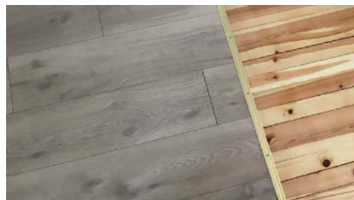
Glippe på laminat mellom stue/kjøkken
