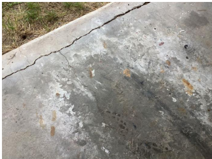
Sprekkdannelse i gulv.
