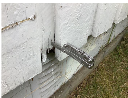
Eksempel på råteskade.
