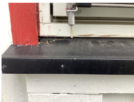
Eksempel på vindu med vedlikeholdsbehov.
