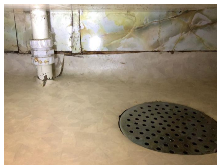
Utett rundt avløpsrør, og vinylbelegg er ikke ført tilstrekkelig høyt på vegg.
