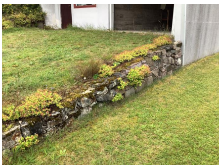
Forstøtningsmuren utgjør en usikret kant.
