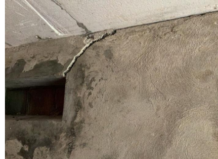
Sprekkdannelse i murvegg.
