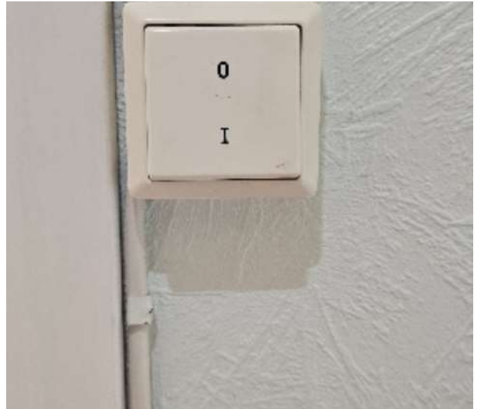
Bilde 2 Opplegg lys i stue over vindu er ikke installert av fagfolk og avmantling er utenfor kapsling.
