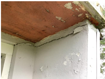
Sprekkdannelse i grunnmur ved balkong og garasje.
