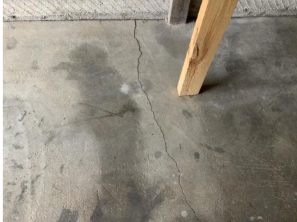
Sprekkdannelse i gulv.
