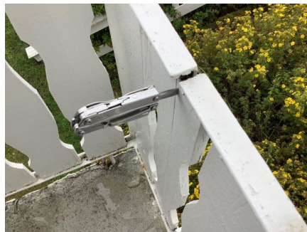
Eksempel på råteskadet rekkeværksbord.
