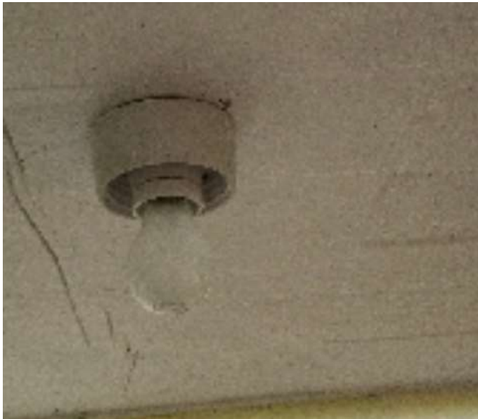
Bilde 1 Mangler kuppel på beslag i kjeller.
