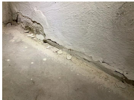
Saltutslag på synlig murvegg.
