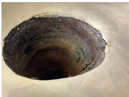
Støpejernsluk, uten tett overgang mellom vinylbelegg og sluk.
