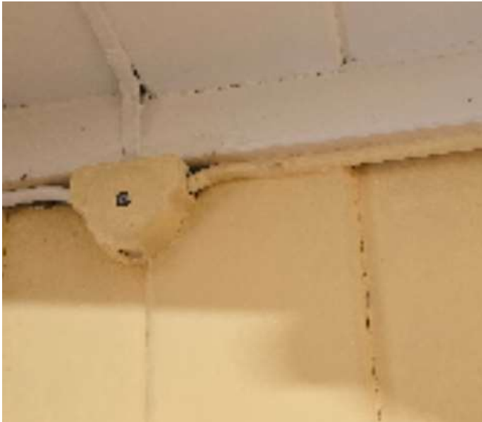
Bilde 1 En del eldre bokser som har oppnådd levealderen sin. Denne i hall før stue et defekt og bør skiftes.
