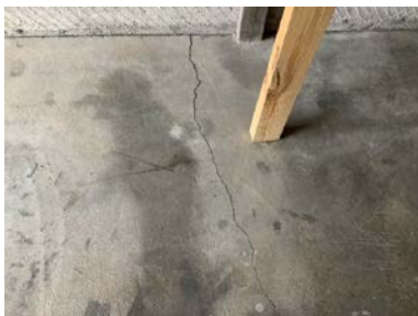
Sprekkdannelse i gulv.
