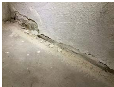
Saltutslag på synlig murvegg.
