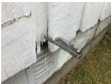
Eksempel på råteskade.
