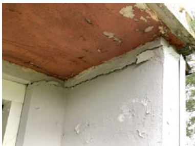
Sprekkdannelse i grunnmur ved balkong og garasje.
