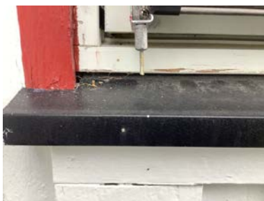
Eksempel på vindu med vedlikeholdsbehov.
