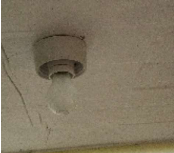
Bilde 1 Mangler kuppel på beslag i kjeller.
