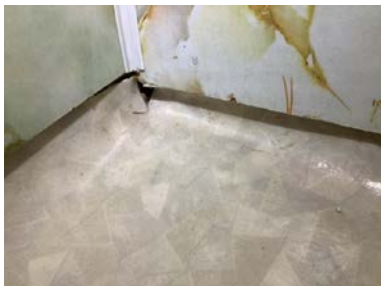
Utett hjørne i vinylbelegget.
