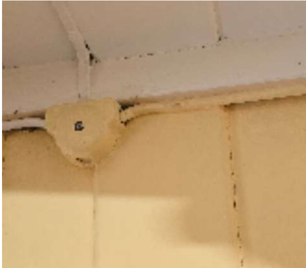
Bilde 1 En eldre bokse som har oppnådd levealderen sin. Denne i hall før stue et defekt og bør skiftes.
