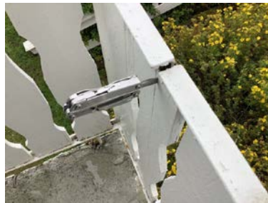
Eksempel på råteskadet rekkverksbord.
