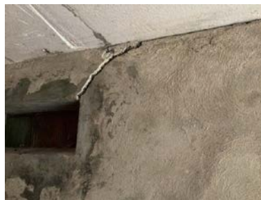
Sprekkdannelse i murvegg.
