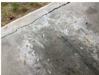
Sprekkdannelse i gulv.
