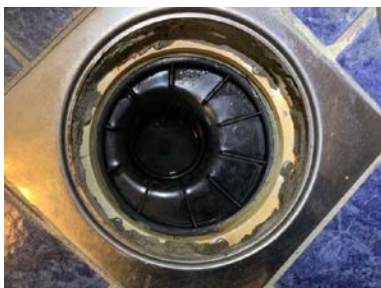
Plastsluk, og slukmansjett er synlig ført under slukets klemring.
