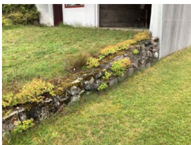
Forstøtningsmuren utgjør en usikret kant.
