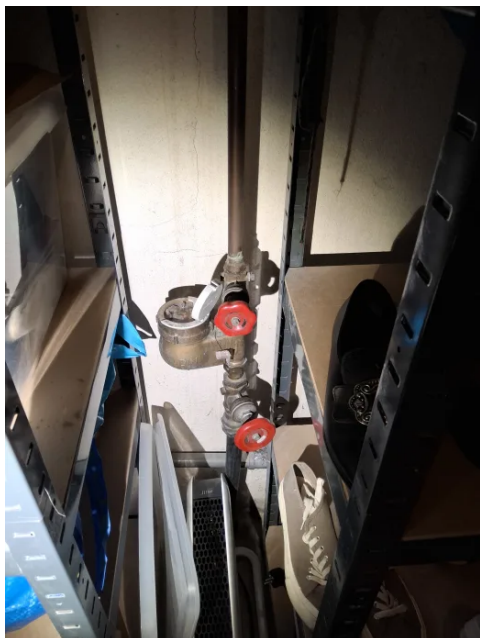
Hovedstoppekrane er plassert i kjeller.
