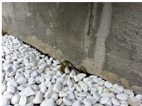
Det er ikke synlig grunnmursplast på hovedparten av boligen.
