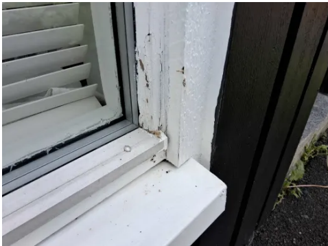
Vinduer er værslitte.
