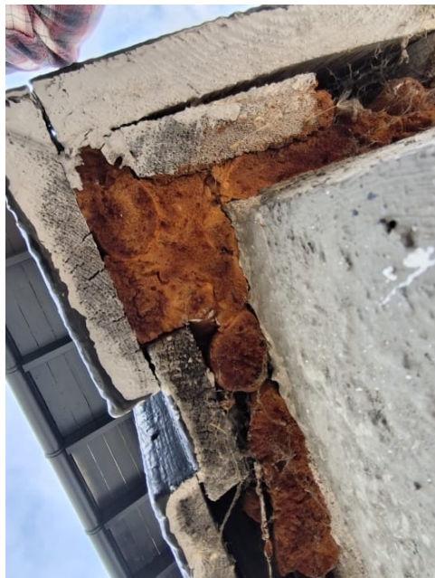
Luftespalter er stedvis tettet med byggeskum.
