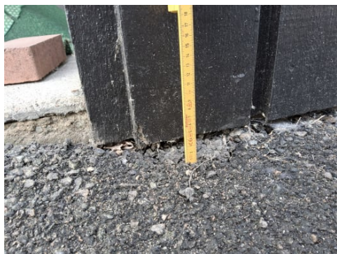
Kledningen er stedvis avsluttet nærme terreng.
