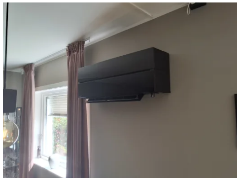
Varmepumpe er plassert i stue.
