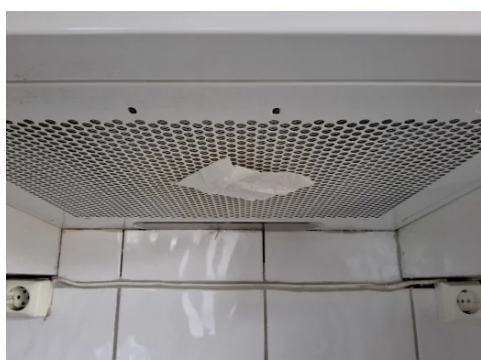
Avtrekkseffekten er testet med papir.
