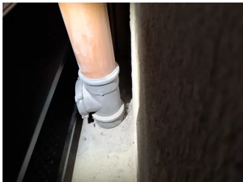
Stakeluke er plassert i kjelleretasje.
