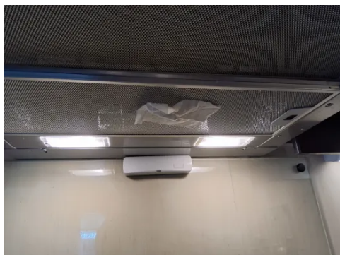
Avtrekkseffekten er testet med papir.
