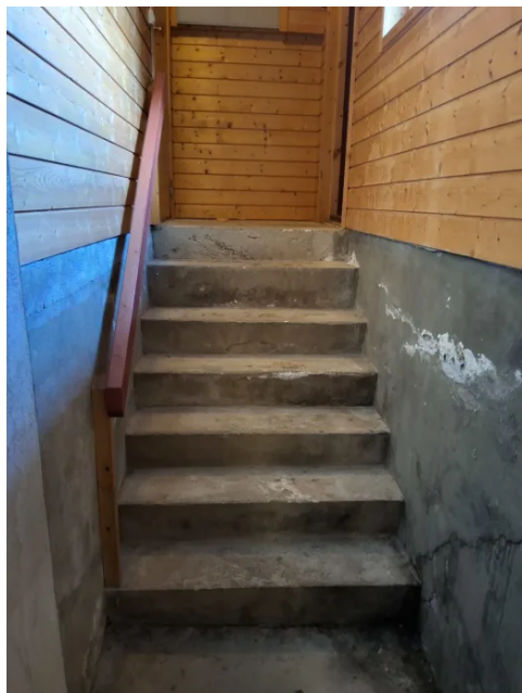
Trappen har ikke håndløper på begge sider.
