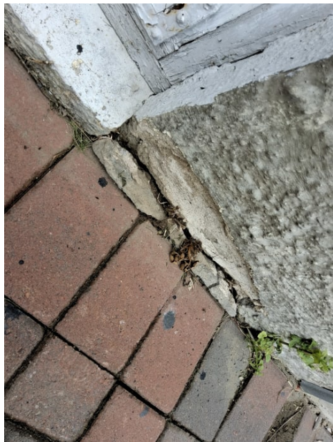
Det registreres stedvise pussavskallinger på grunnmuren.
