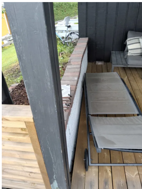
Det registreres skjevheter i rekkverk/mur.
