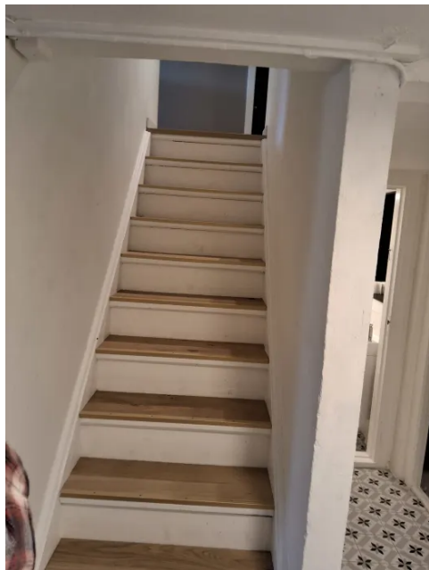
Trappen mangler håndløpere.
