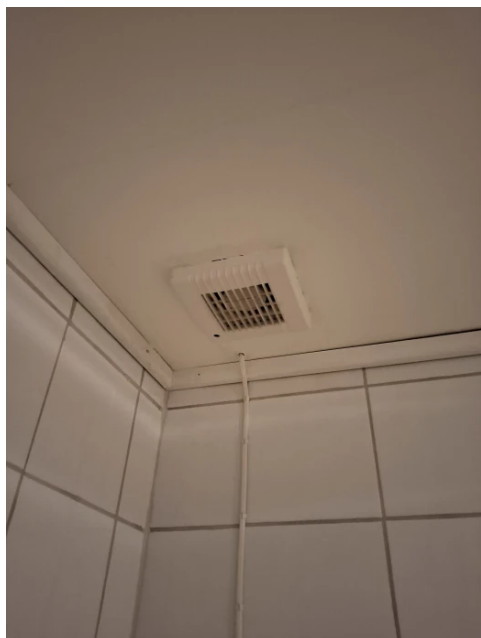
Avtrekksvifte er defekt.
