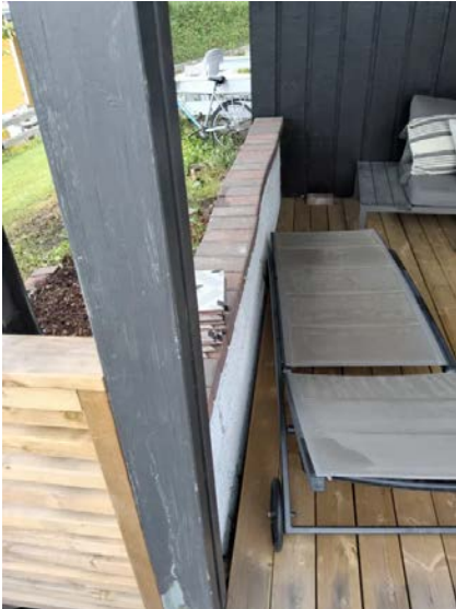
Det registreres skjevheter i rekkverk/mur.
