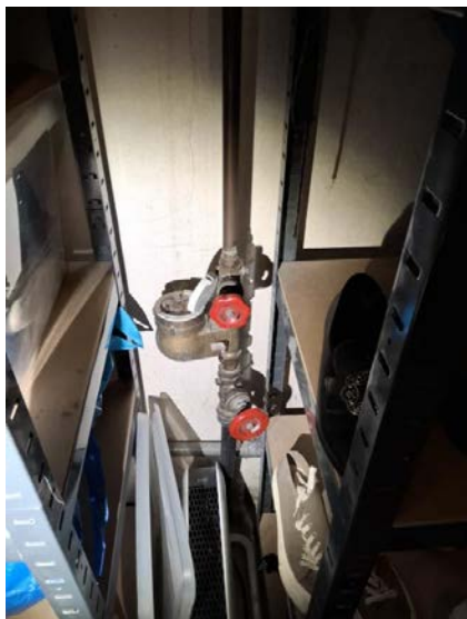
Hovedstoppekran er plassert i kjeller.
