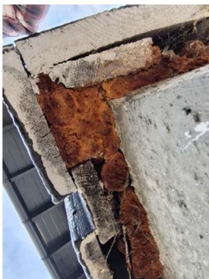
Luftespalter er stedvis tettet med byggeskum.
