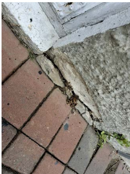
Det registreres stedvise pussavskallinger på grunnmuren.
