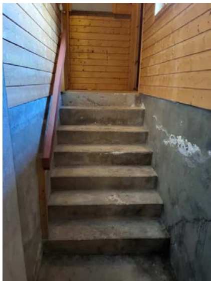
Trappen har ikke håndløper på begge sider.
