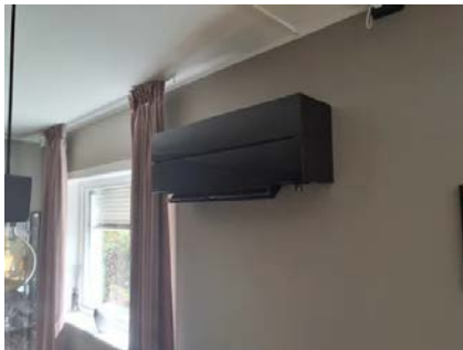
Varmepumpe er plassert i stue.
