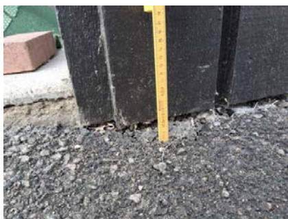
Kledningen er stedvis avsluttet nærme terreng.
