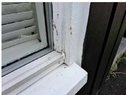
Vinduer er værslitte.
