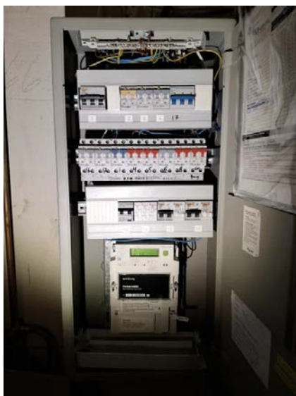
Sikringskap til hoveddel er plassert i kjeller.
