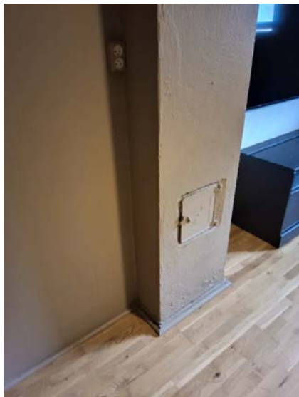
Innkassing i kjelleretasje er plassert tett mot pipen.
