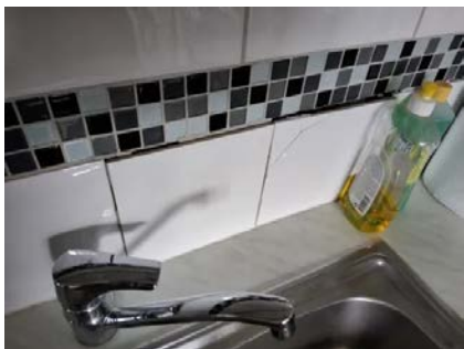
Fliser har løsnet og sprukket.
