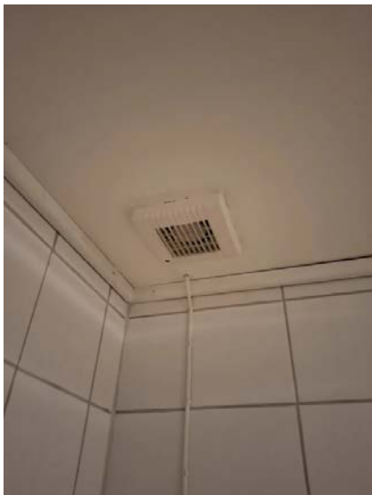
Avtrekksvifte er defekt.
