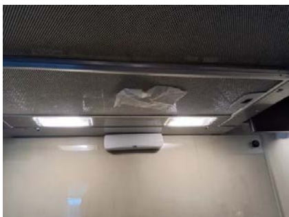
Avtrekkseffekten er testet med papir.
