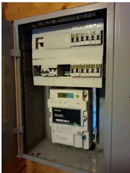
Sikringskap til uteiedel er plassert i trappegang.
