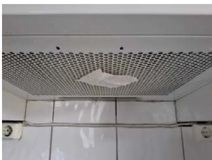
Avtrekkseffekten er testet med papir.
