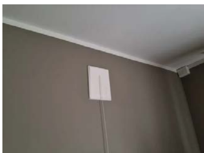
Naturlig ventilasjon med klaffventiler på yttervegger.
