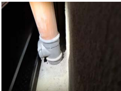
Stakeluke er plassert i kjelleretasje.
