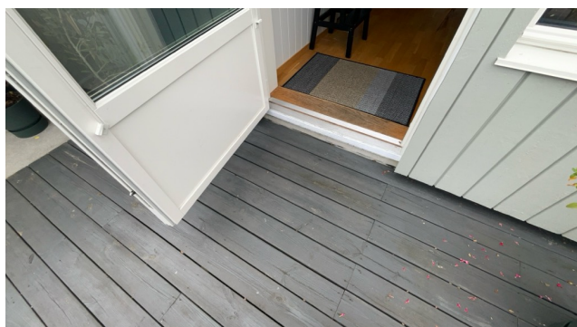
Skadet list under terrassedør.
