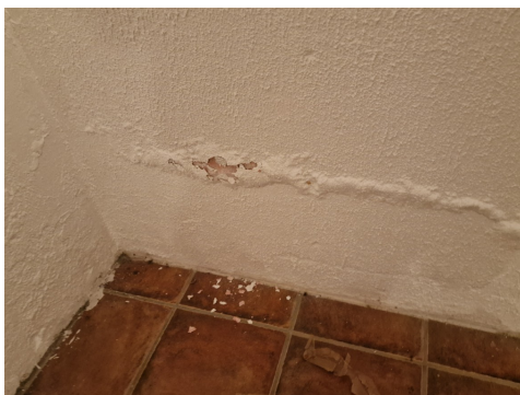
Saltutslag på vegg.
