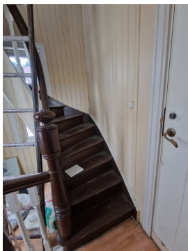
Trapp mellom 2. og 3. etg, mangler håndløper på vegg.
