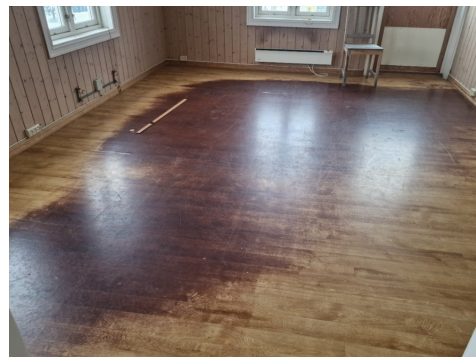
Bruksslitasje, fargeforskjell gulv 2. etg.
