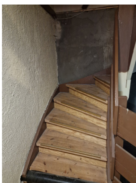
Trapp til kjeller, mangler håndløper på vegg.
