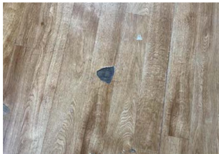
Skade gulv 2. etg.
