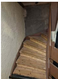
Trapp til kjeller, mangler håndløper på vegg.
