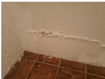
Saltutslag på vegg.
