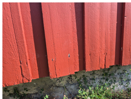
Råte i bunn av kledningsbord.
