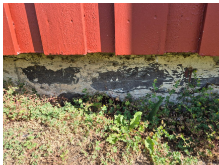
Sprekker i ringmur.
