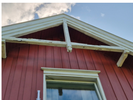
Råteskader i mønekruss.
