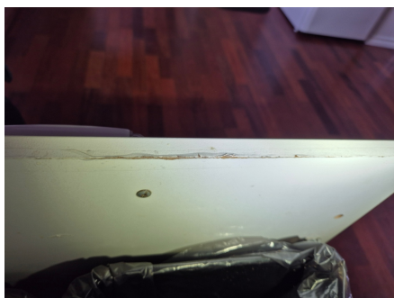
Noe fuktsveller i topp av skapdør under vask.
