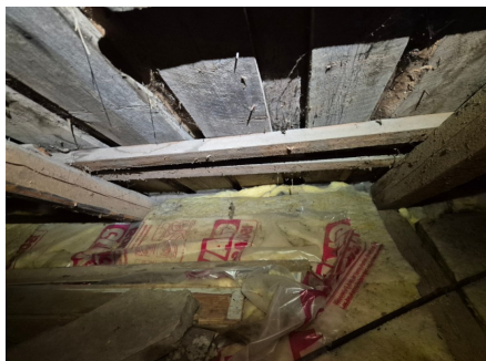
Ingen lufting i nedre del.
