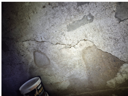
Sprekker i grunnmur i kjeller.
