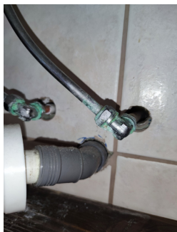
Ikke tett rundt rørgjennomføringer.
