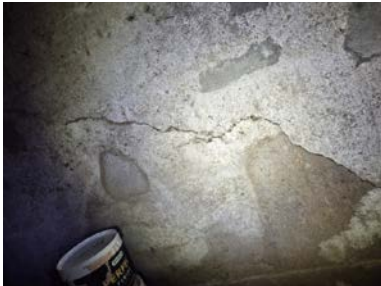
Sprekker i grunnmur i kjeller.
