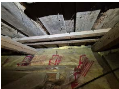
Ingen lufting i nedre del.
