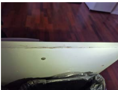
Noe fuktsveller i topp av skapdør under vask.
