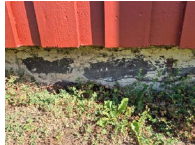
Sprekker i ringmur.
