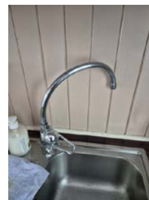
Kjøkkenkran uten stoppfunksjon.
