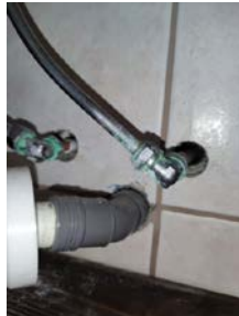
Ikke tett rundt rørgjennomføringer.
