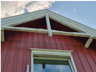
Råteskader i mønekryss.
