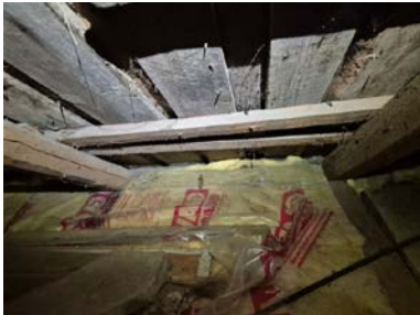
Ingen lufting i nedre del.
