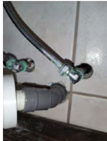
Ikke tett rundt rørgjennomføringer.
