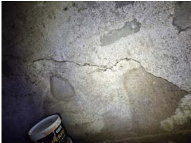
Sprekker i grunnmur i kjeller.
