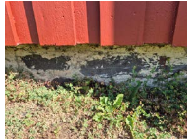
Sprekker i ringmur.
