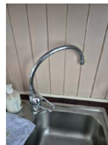
Kjøkkenkran uten stoppfunksjon.
