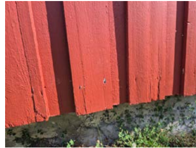
Råte i bunn av kledningsbord.
