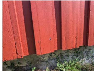
Råte i bunn av kledningsbord.
