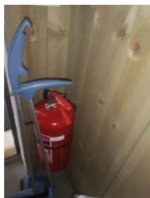
Brannslukker plassert i utebod.
